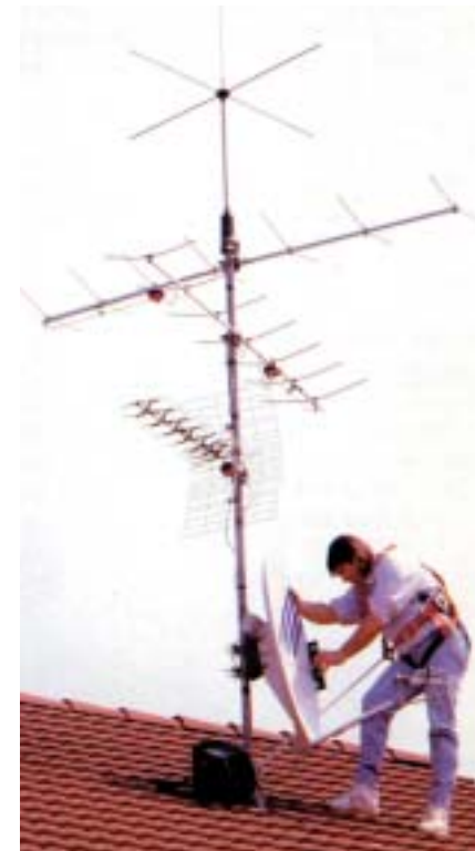
Bei der Installation einer Sat-Antenne auf dem Dach sollte man auch auf den nötigen Blitzschutz achten
