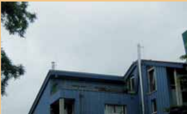
Bild 1: Gebäude mit Äußerem Blitzschutz und metallener Abgasanlage in einer und außen an einer baulichen Anlage. Fangstange mit Schutzwinkel, Distanzhalter aus Isolierstoff, Anschluss der Fangstange an die Fangeinrichtung.
