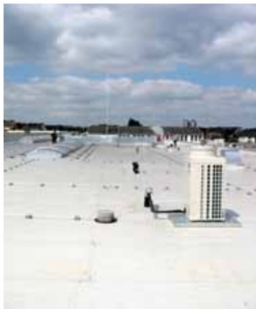
Fangstange mit zwei Betonsockeln zur Absicherung eines Klimagerätes.
