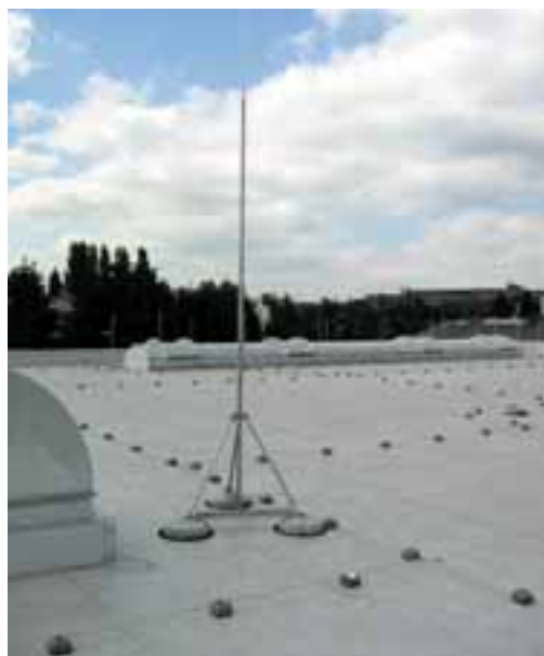
Fangmast zur Absicherung ausgedehnter, hoher Aufbauten.
